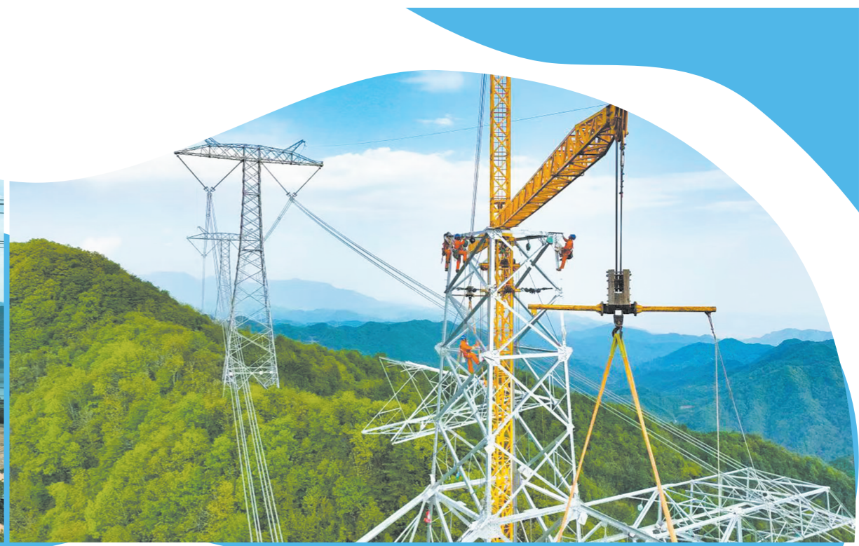
±800千伏祁韶线抗冰改造工程中,国网陕西电力员工正在采用落地双摇臂抱杆进行铁塔组立
